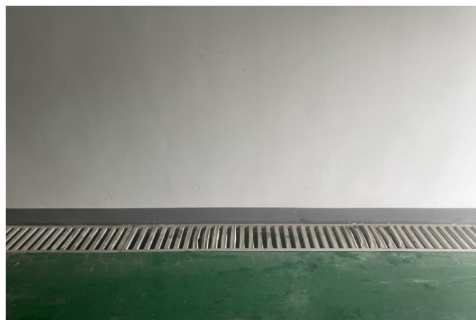
地面防渗、导流沟
